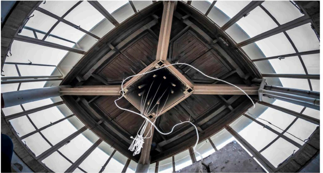
Een lichtslang hangt bovenin de toren van het Murellius Gymnasium. Luiken in het dak van de sterrenwacht zijn dicht gelast.
